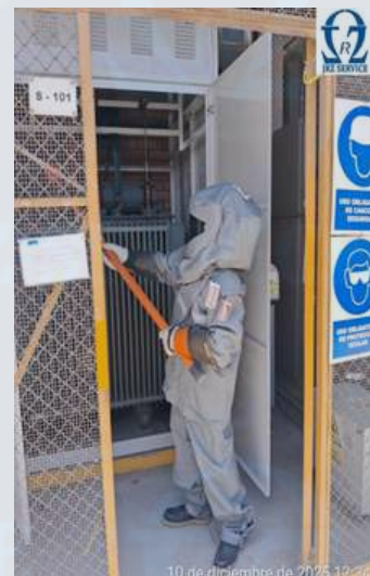
Medición de presencia de tensión.
