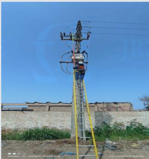
Corte de energía desde seccionador cut out.
