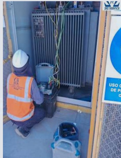
Medición de resistencia de bobinas de transformador
